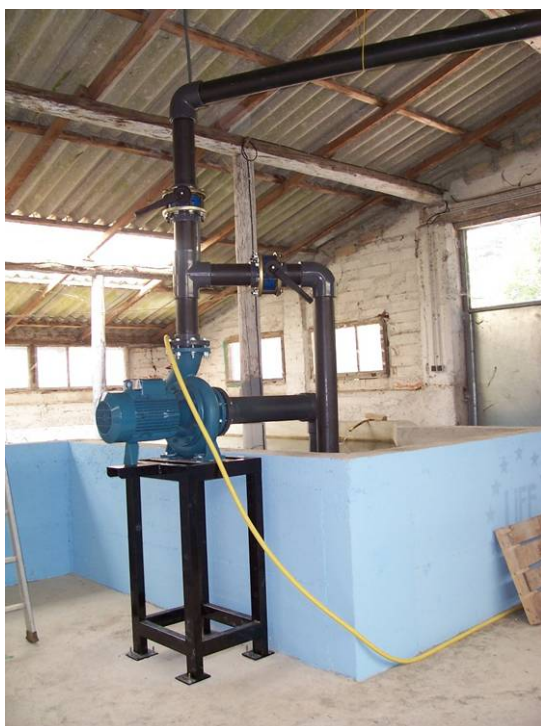
Figure 27. Photo de la pompe à débit variable
