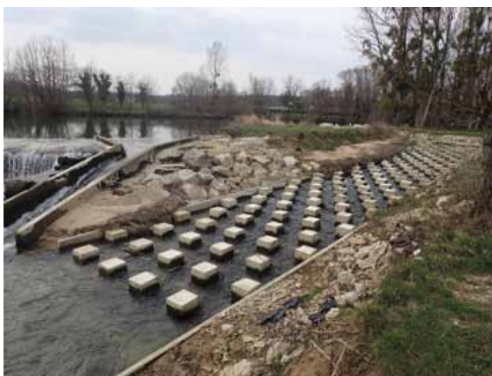
Photos 19 : Passe à poissons du barrage de Roche © M. Georget
