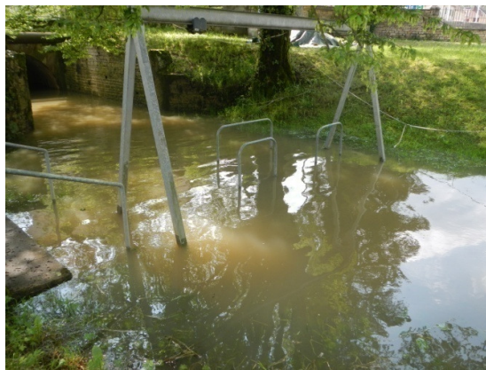
Figure 10 : piège ennoyée par l'aval lors d'une crue
